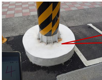
廣告燈塔未配置接地線
