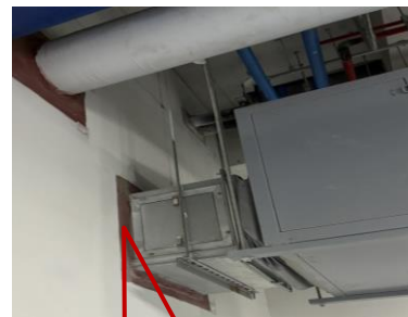
空調風管 貫穿防火牆應 防火填塞完整
